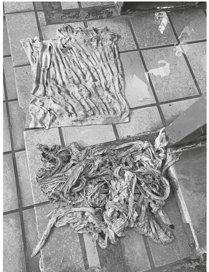
Kleidungsstücke die in Ursendorf aus der Pumpe entfernt werden mussten!
